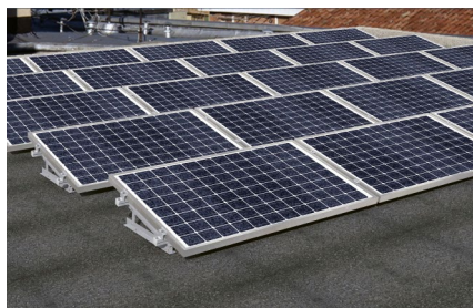
Vodorovná instalace solárních panelů
