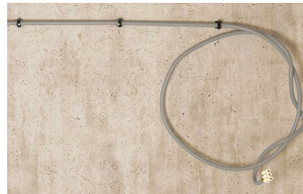
Upevnění jednotlivých kabelů
